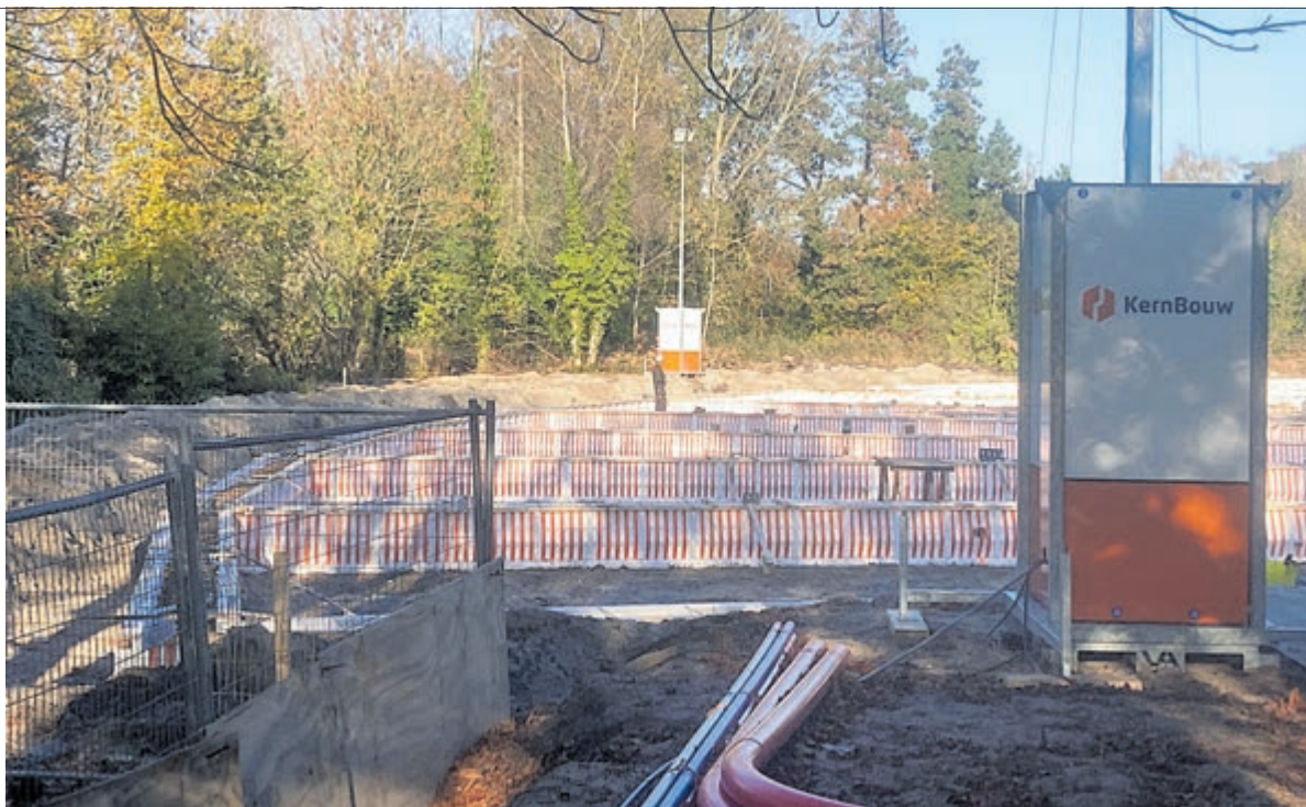
Er wordt hard gewerkt aan de fundering van de nieuwe Nicolaas Beetsschool.
